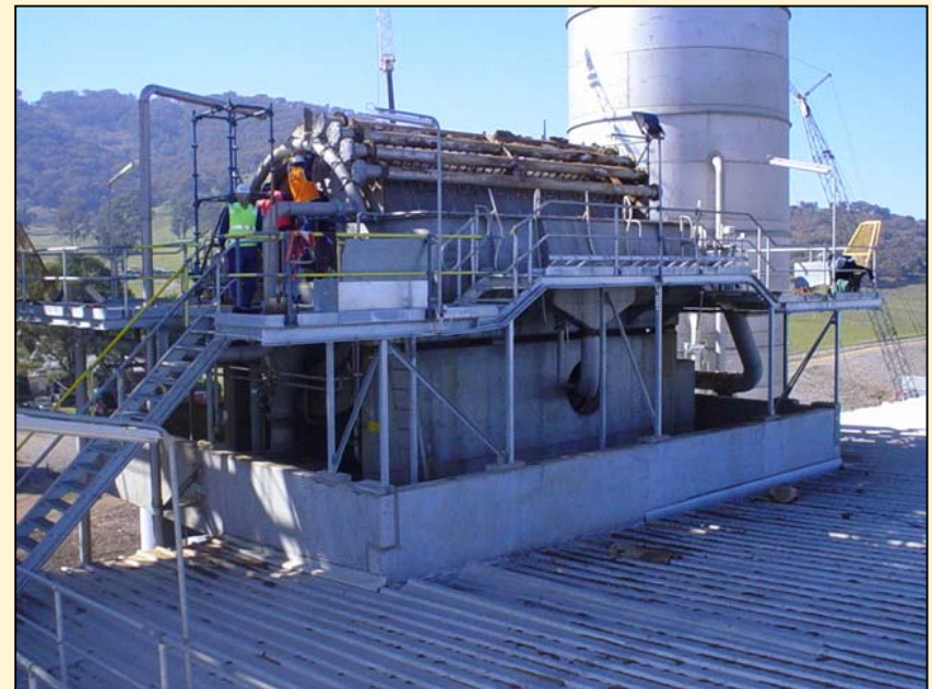
Vue d'ensemble d'une unité de lavage
